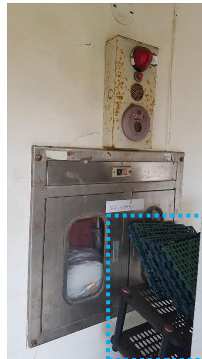
B棟消防栓前
