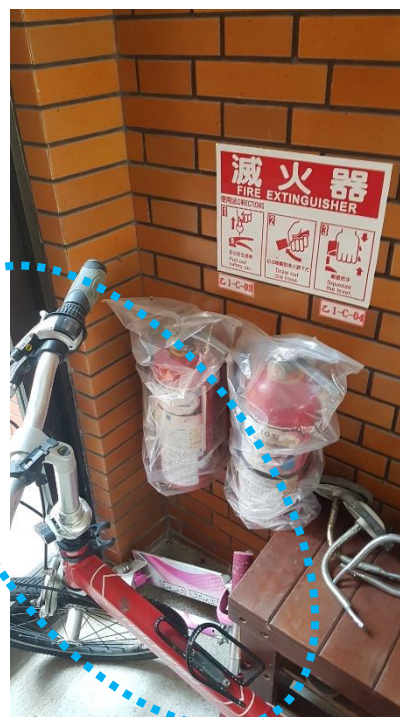
乙棟滅火器前
